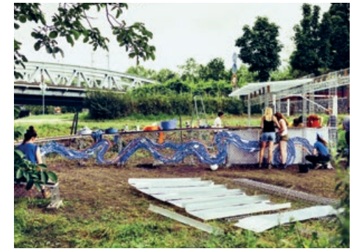
Chantier du bar extérieur de l'Orée 85 en matériaux de réemploi © Abdesslam Mirdass
